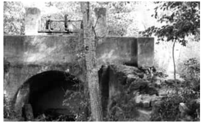
Alcozarejos: toma de agua de la central
