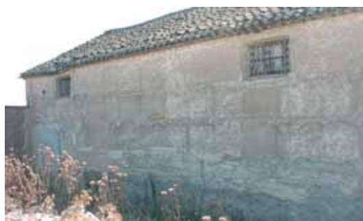
Ejemplo similar en nave cercana, sin brecas)
