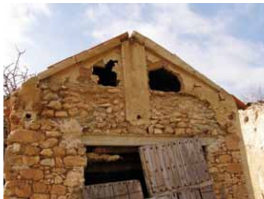
Muro piñón. Viga cumbreira apoyada en machón de adobe. Relleno de adobe. Aldea de Puente Torres
