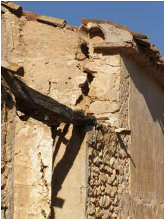
Grieta vista desde el exterior. La anchura y profundidad de la grieta es mayor en la parte alta del muro.
