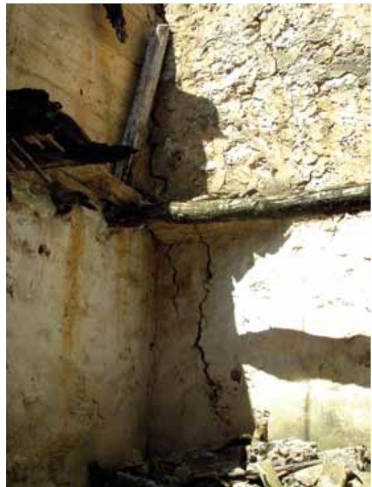
En el transcurso de cuatro años de abandono las grietas se hacen más pronunciadas (2006-2010)
