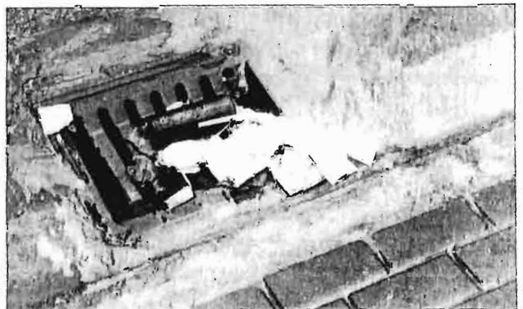
Después de la tormenta. Como viene siendo habitual, después de la tormenta registrada en la mañana de ayer, los Imbornales de la ciudad mostraban este aspecto. Parece que no funcionan al 100%. FOTO MANUEL PODIO.
