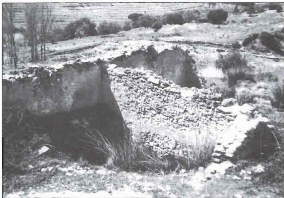
Foto n.º 6. Estado actual de los Baños de la Fuente del Buitre. Debajo de los juncos del primer término esta el manantial.
