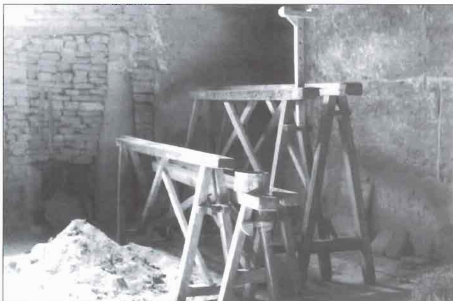
Andamios y listones de la fábrica de J. Gimena. Al fondo incluido en la pared un «pilot». (Fot. García Gómez).
