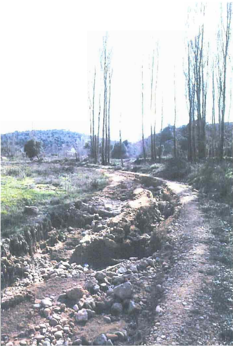
Foto 11. Pista forestal de acceso a la Laguna del Arquillo desde la localidad próxima de El Jardín. Instantánea tomada en marzo de 1997, cuando el río aumentó de caudal y rebasó la barrera travertínica, barriendo por completo el vial de acceso.
