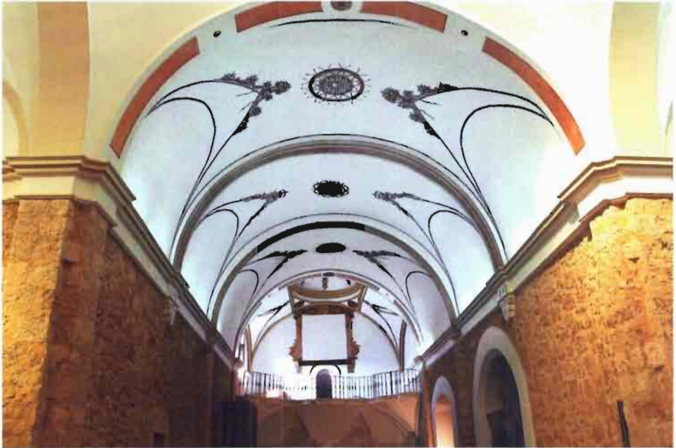
Fot. 10. Iglesia parroquial de Nuestra Señora de las Nieves. Cenizate. Interior. Nave.
