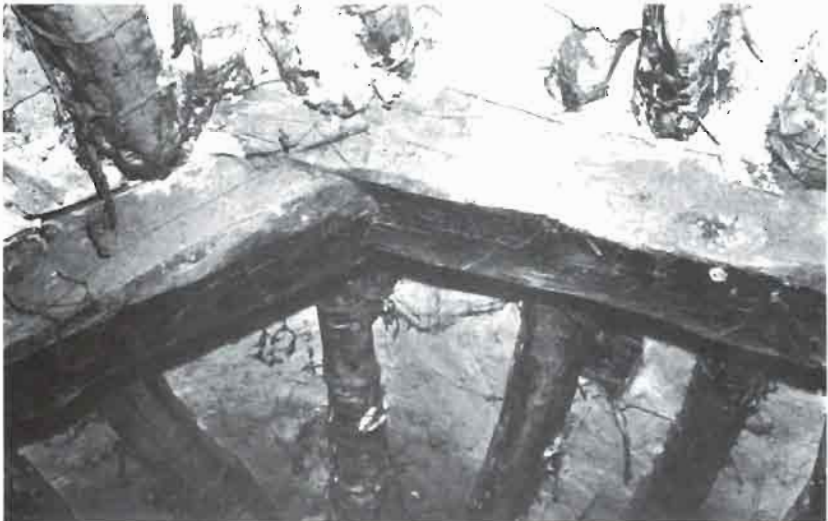
FOTO 55. Detalle de la intersección de los pares de una cercha de la Venta del Puerto.
