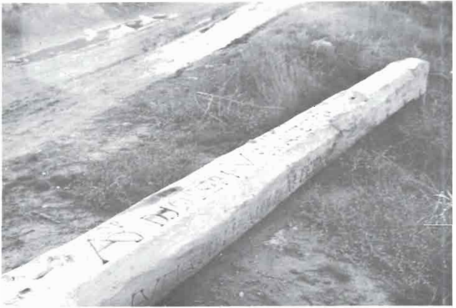
Otra de las caras de la viga.
