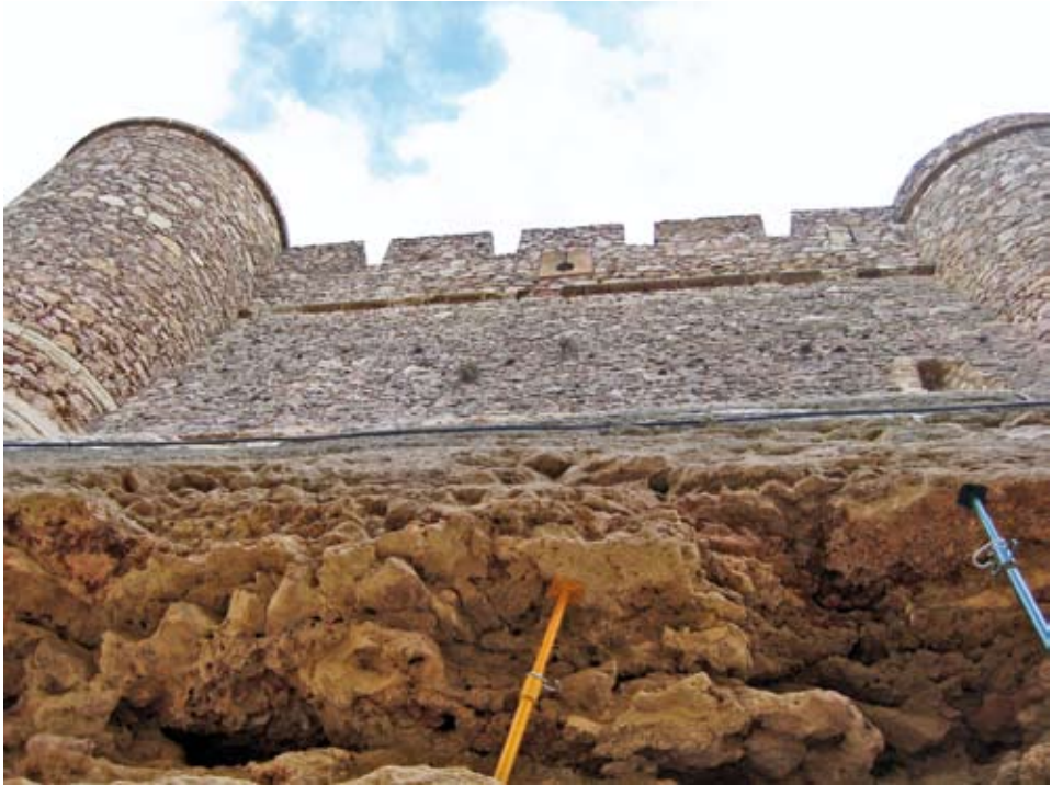
Fig. 3. Vista del lienzo desde la base del foso, donde se aprecian las cárcavas.
