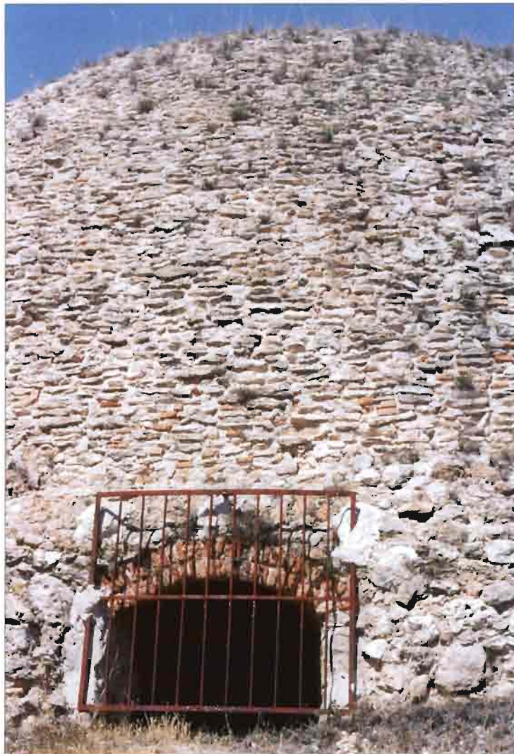
Foto 2 ► Boca de carga
