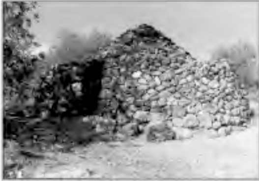
Foto 5.- Cuco Amparo Pérez Sánchiz. Situada en La Rocha, es de tamaño mediano, y tal vez donde la reconstrucción ha sido, junto con el Cuco de Miguel G. Bleda, de los más espectaculares por la diferencia entre el principio y el resultado final. El muro que vemos en primer plano estaba casi todo en el suelo, por lo que la intervención era absolutamente necesaria.
