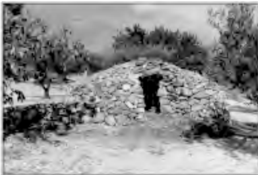
Foto 6.- Cuco de Mónica Peinado. Muy cercano al pueblo, situado en la partida de Las Turmas, es uno de los más pequeños y, debido a la escasez de muro, uno de los más castigados. Su reconstrucción ha sido muy importante, puesto que tan sólo quedaba el muro suficiente para sujetar, no sin grandes peligros, de la cubierta.
