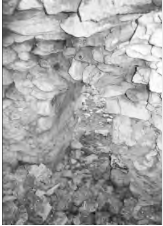
Número 29. Detalle del cierre interior de la puerta mediante el uso de dovelas.
