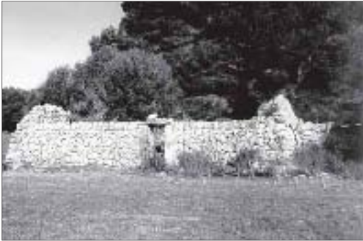
“Barraca de roter” con la cubierta derruida.
