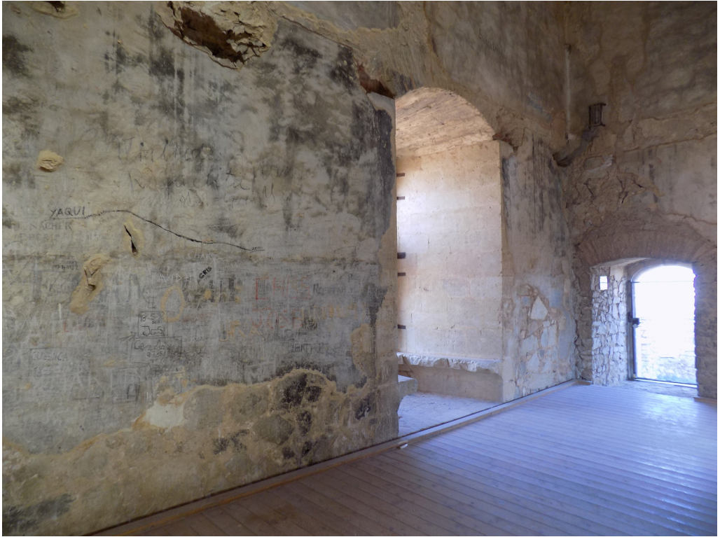
Figura 2. Salón principal de la torre del homenaje o T1, espacio donde se concentran la mayor parte de los graffiti efectuados durante la Guerra Civil Española.
