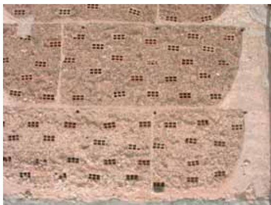
Tapia con juntas reforzadas y breccas en las jambas en este caso los ladrillos incrustados quedan a la vista al perder el revestimiento (Villarrobledo)
