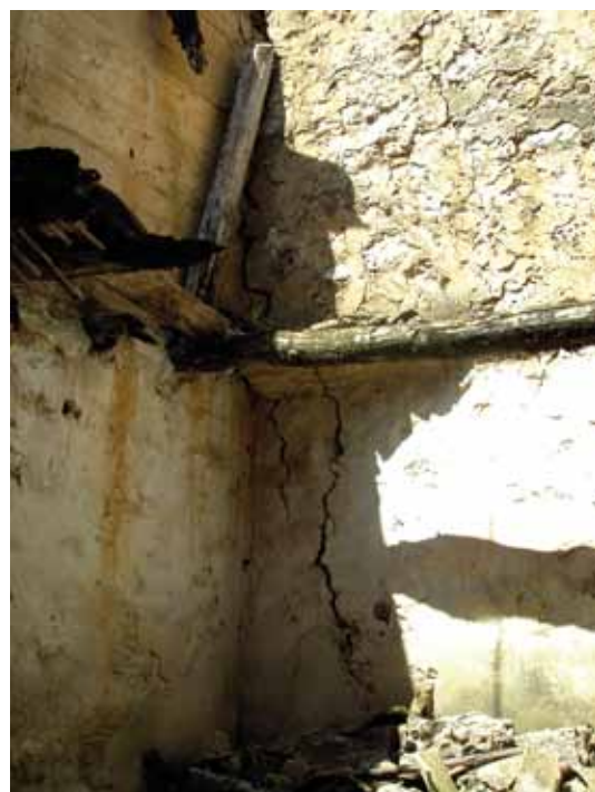
En el transcurso de cuatro años de abandono las grietas se hacen más pronunciadas (2006-2010)
