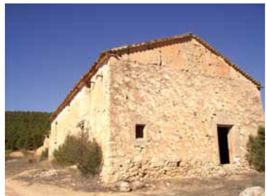
En la parte baja del muro se está produciendo una importante pérdida de mortero de agarre entre mampuestos
