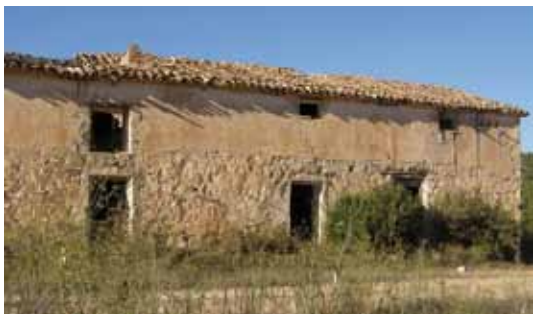
Fachada sur de la vivienda. Acceso a la cuadra y a la vivienda
