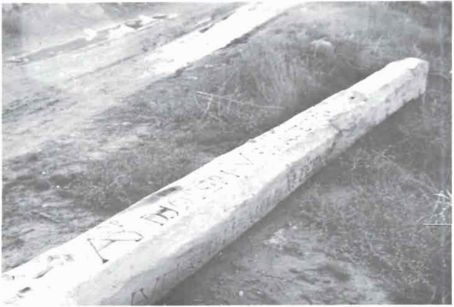
Otra de las caras de la viga.
