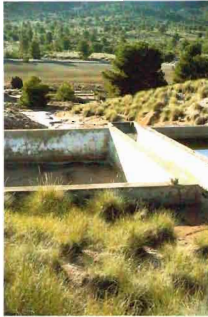
Foto 3: Vista parcial de las albercas o balsas de almacenamiento en el salero nuevo.
